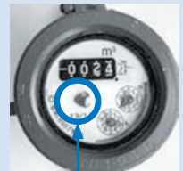
ここが回転しているか確認 ※メーターは一例です。
