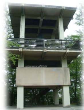
劣化が著しい鐘楼
