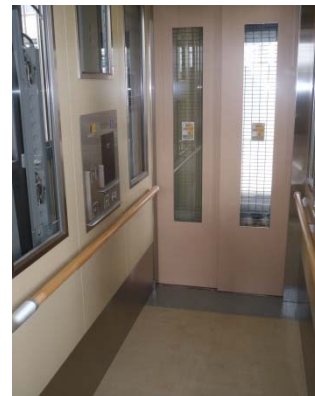
エレベーター室内
