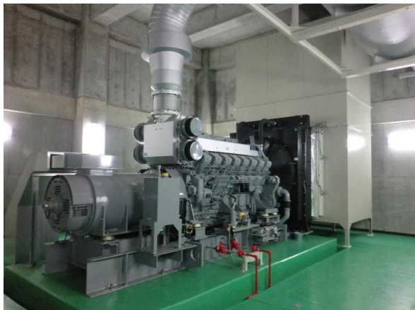
非常用発電設備
