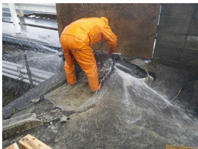
水道管の漏水
