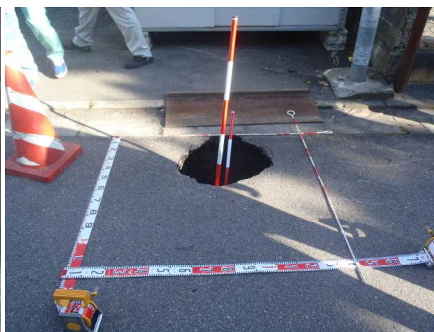
老朽化した下水管による道路陥没
