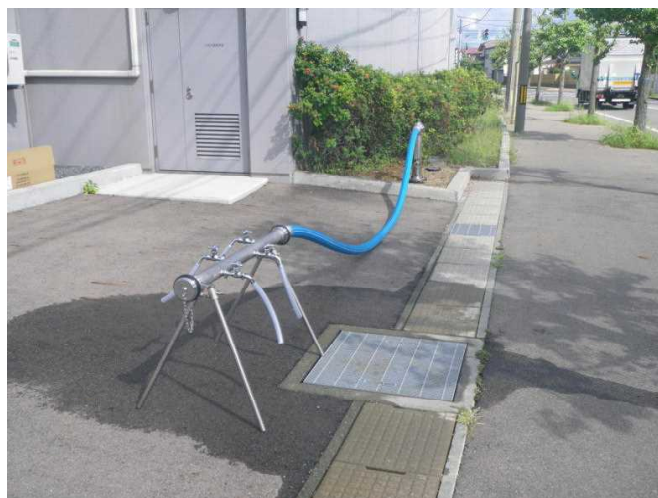
応急給水施設（応急給水栓）
