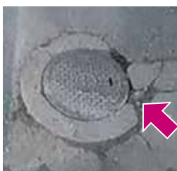
公共汚水ますの破損
