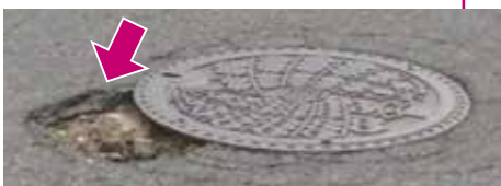
マンホール周囲の舗装破損
