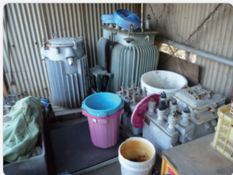
倉庫に残された変圧器・コンデンサー
