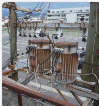
高所に残置された変圧器
