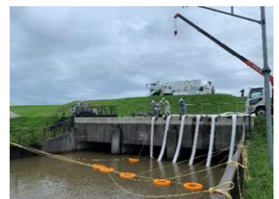
令和4年8月の排水状況
