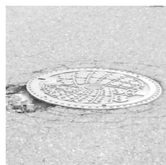
マンホール周囲の舗装破損
