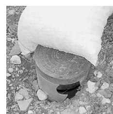
公共汚水ますの破損
