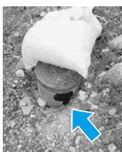
公共汚水ますの破損
