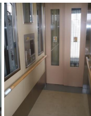
▲エレベーター室内
