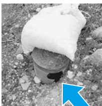
公共汚水ますの破損
