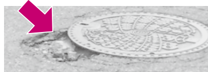
マンホール周囲の舗装破損
