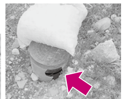
公共汚水ますの破損
