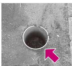
公共汚水ます蓋の紛失
