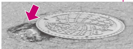
マンホール周囲の舗装破損
