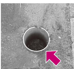
公共汚水ます蓋の紛失
