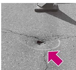
下水道管上の路面陥没
