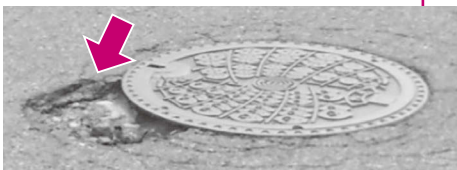
マンホール周囲の舗装破損
