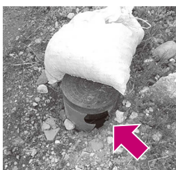
公共汚水ますの破損
