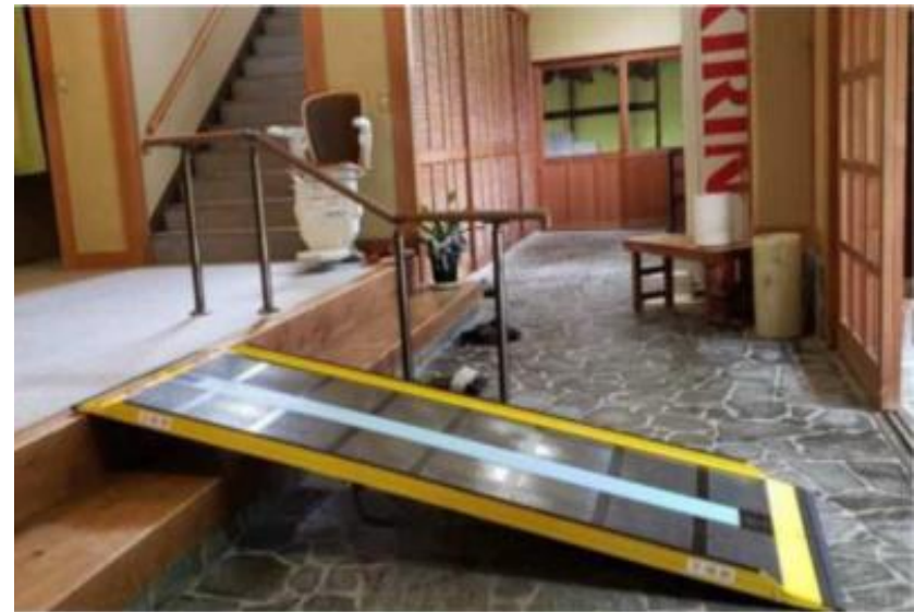
スロープの設置 福岡県宿泊税検討委員会報告書（令和5年9月）より
