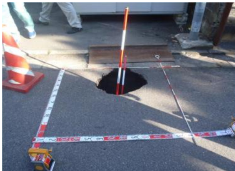
老朽化した下水管による道路陥没
