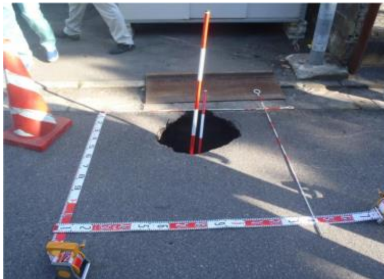
老朽化した下水管による道路陥没
