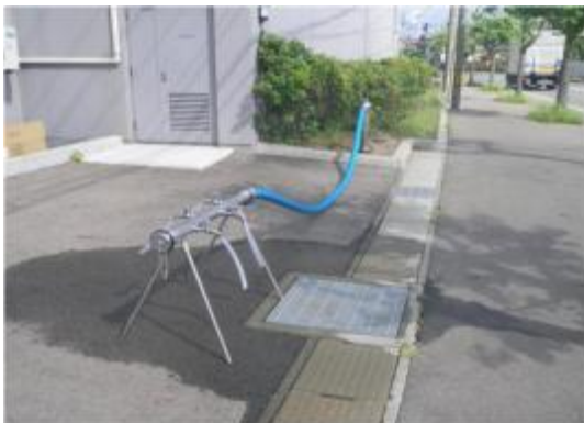
応急給水施設（応急給水栓）
