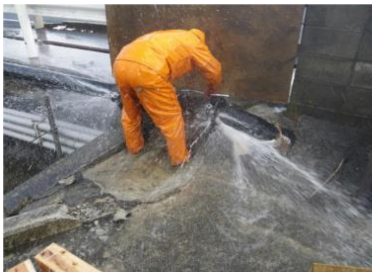
水道管の漏水
