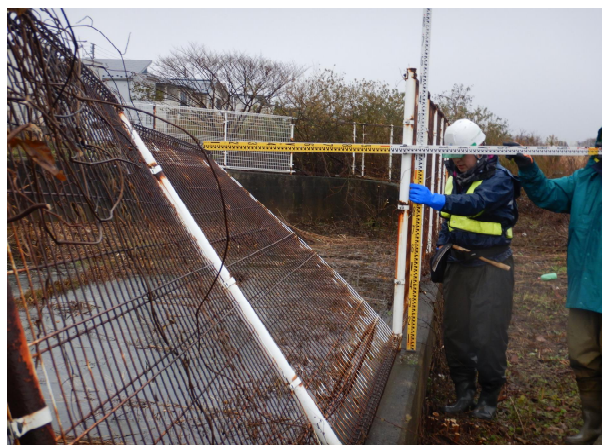
南部ニュートウン大野調整池 防護柵変形
