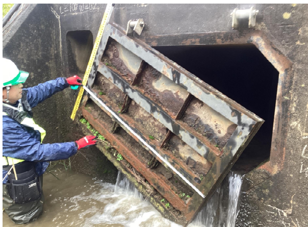
ニュートウン御野場第3調整池 ゲート開閉不全
