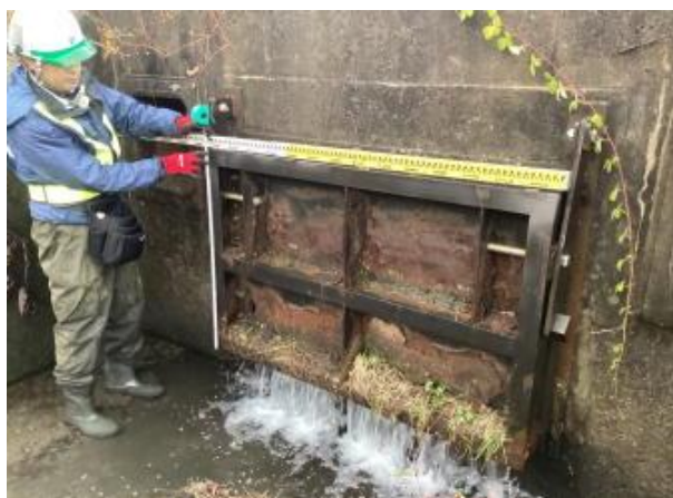
ニュートウン御野場第4調整池 ゲート腐食欠損
