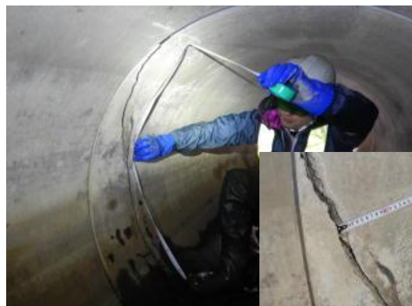
第2 ヴァンベール大平台調整池 函体クラック
