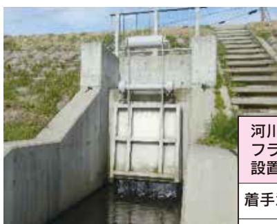
フラップゲートの整備例
