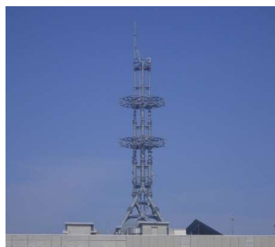
無線基地局（市庁舎屋上）
