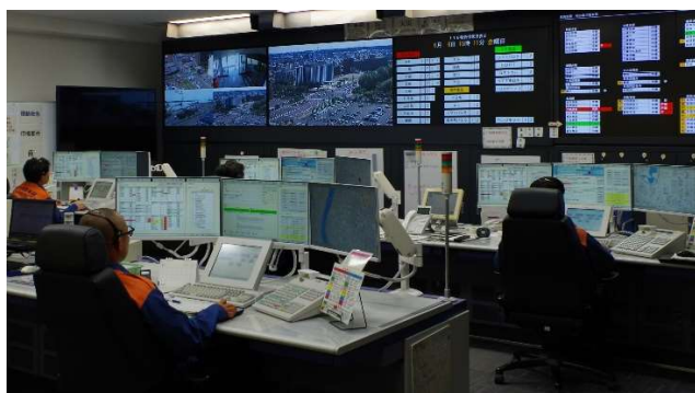
現在の消防指令センター（消防庁舎3階）
